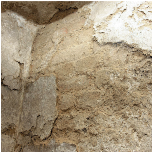
Kellerräume mit Feuchte- und Salzsäden vor der Sanierung
