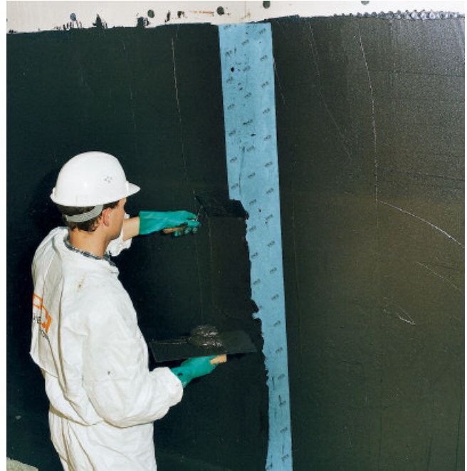
Einlegen des Dichtbandes PCI Pecitape® 250 im Fugenbereich mit nicht bindigem (stark durchlässig, drainagefähig) Boden verfüllt werden.
